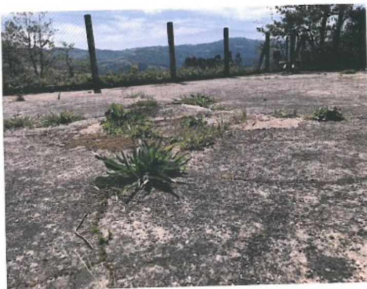
ESTADO DO PAVIMENTO ACTUAL
